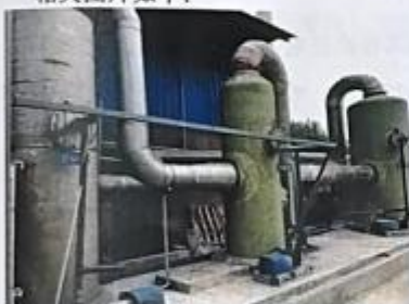
对羟基苯甲醛装置尾气处理
