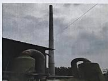
对羟基苯甲醛装置尾气排气筒
