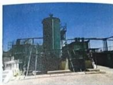
对羟基苯甲腈污水预处理设施
