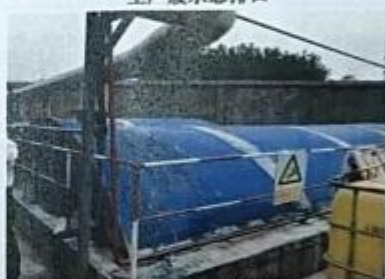
废水预处理设施
