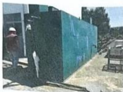
一体化生化污水处理设备
